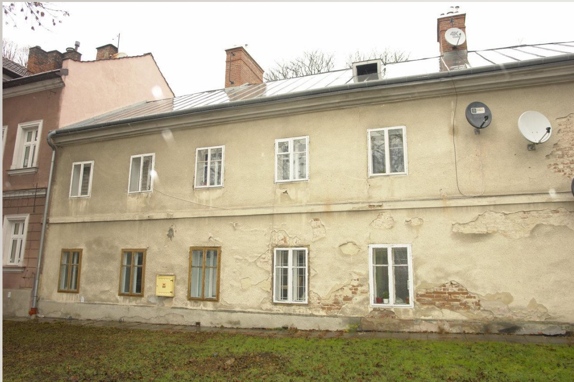
stan przed konserwacją
